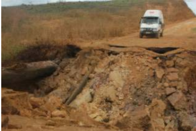
Eine abgebrannte und eingestürzte Brücke
